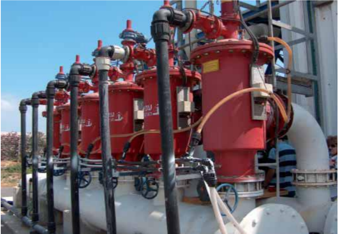
Gedeelte van de waterzuiveringsinstallatie van Maagan Michael.
